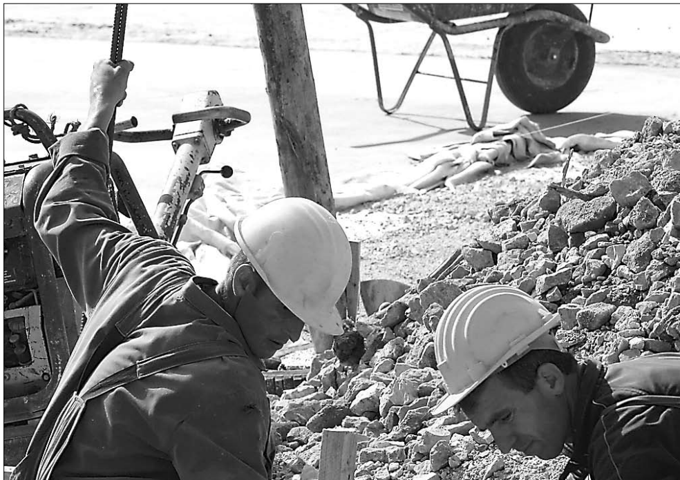
Keves a kőműves, ács, burkoló és vasszerelő, egyes munkák elvégzésénél fennakadások tapasztalhatók
